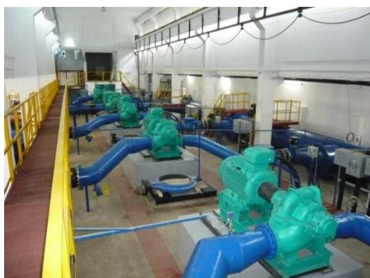
Uzina de apă nr.2- Sala pompelor (foto 2)
