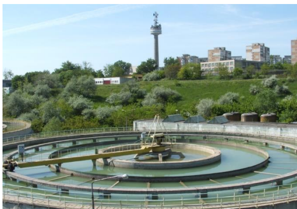
Uzina de apă nr 2-Decantor (foto3)
